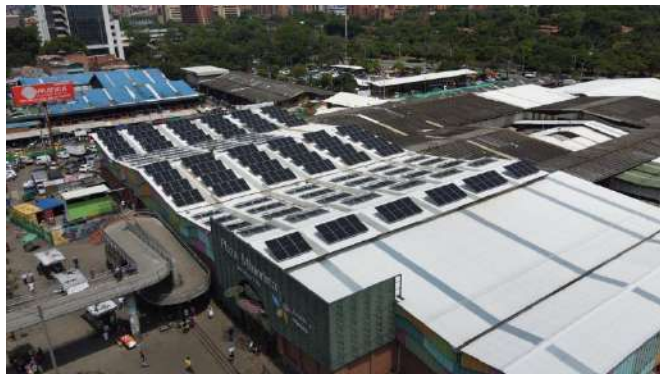
Imagen 2 Sistema de Energía solar
